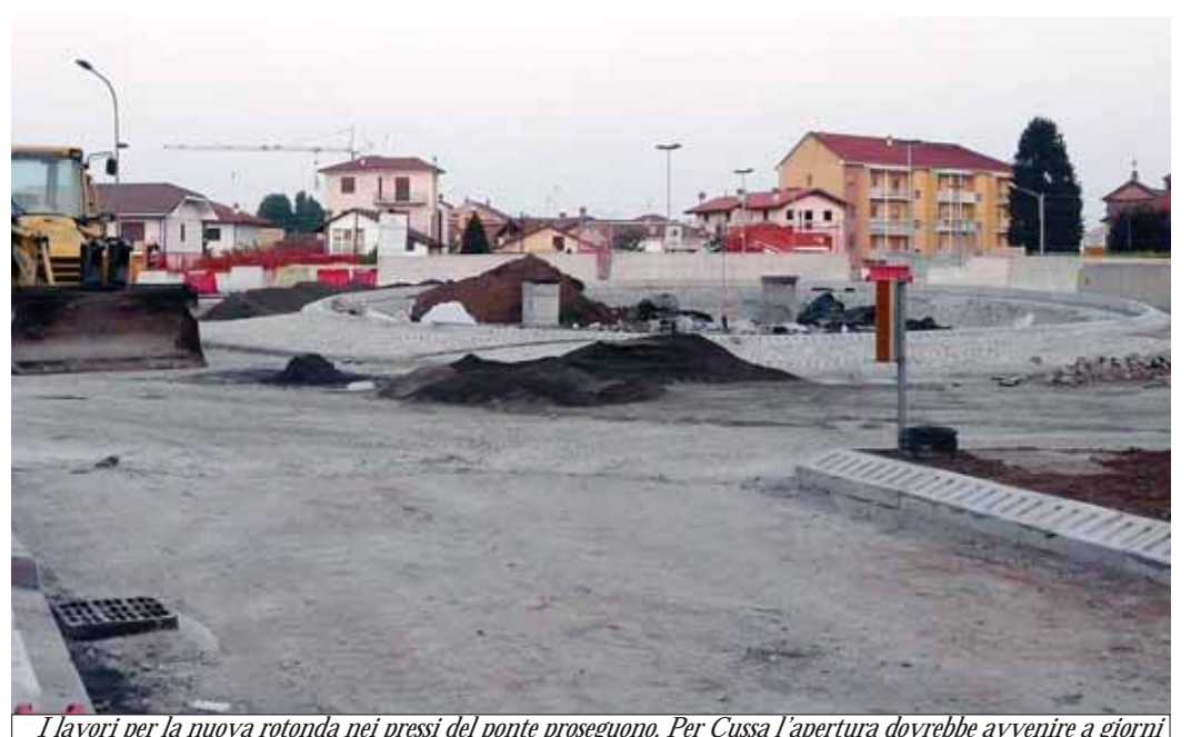
I lavori per la nuova rotonda nei pressi del ponte proseguono. Per Cussa l'apertura dovrebbe avvenire a giorni
