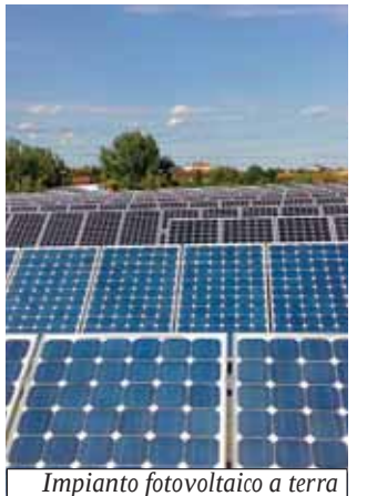
Impianto fotovoltaico a terra
